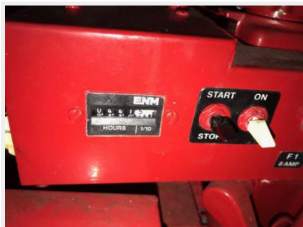
Genset hour meter
